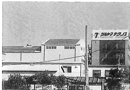
本社工場屋上に設置された太陽光発電装置
